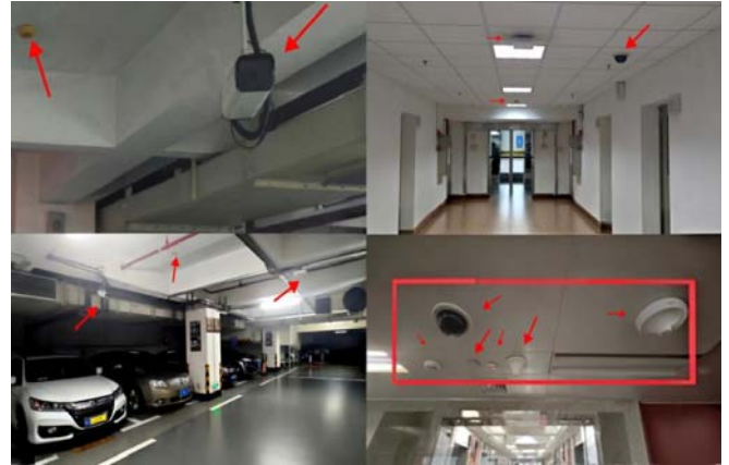
图2 封闭场景5G室+天翼高清终端+智能烟测安防设备一体化布设实景图
