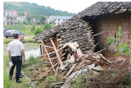
图1 娄星区一危房坍塌
