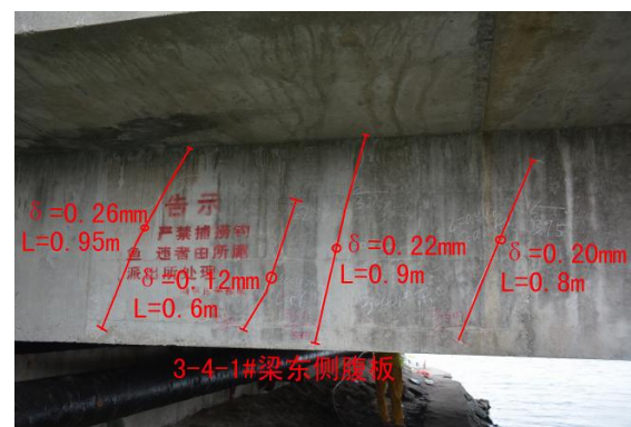
图 2.2 梁端腹板斜向裂缝图
