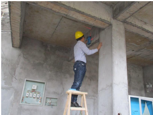
图1 建筑主体混凝土结构裂缝隐患现场检测
