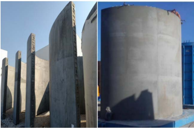
图1 预制混凝土塔筒
