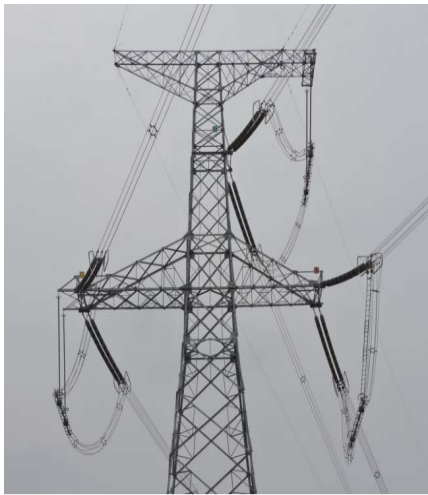
图2 吐巴库二回投运后耐张塔内角侧存在的问题
