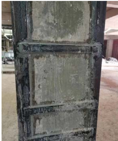
图1 外包钢质注胶加固法(框架柱)
