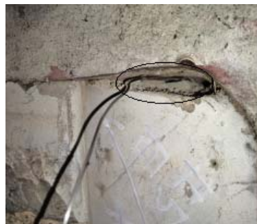
图一轴承座台板与基础接触面存在间隙、脱空
