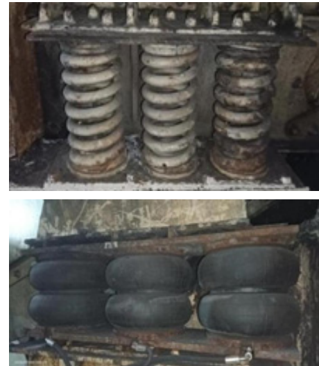
图1 改造后振动筛的橡胶空气减震弹簧现场照片
