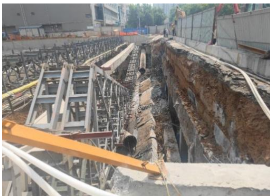
图1 某车站附属基坑冠梁和挡墙倾覆
