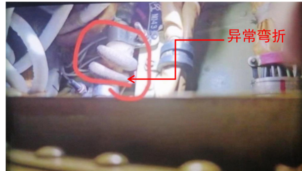
图2 托架下方空调管异常弯折情况
