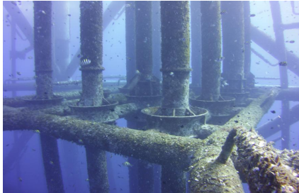
图1 导管架及杆件水下海生物附着情况
