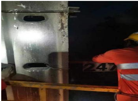
图 3 破损的混凝土支柱 1
