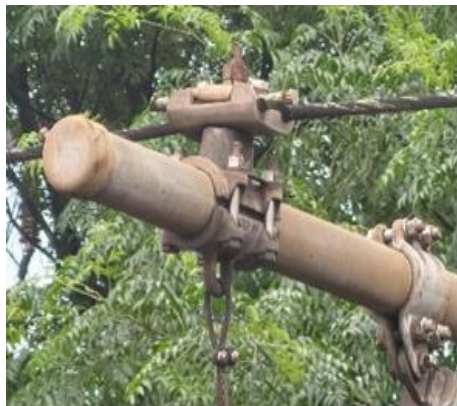
图 9 锈蚀的腕臂支撑装置
