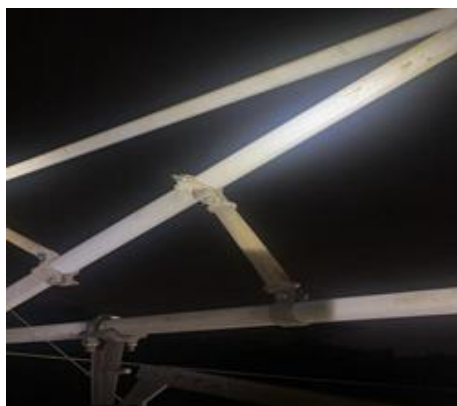
图 10 锈蚀的定位装置
