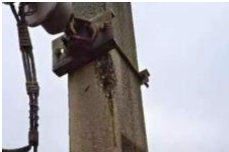
图 4 破损的混凝土支柱 2
