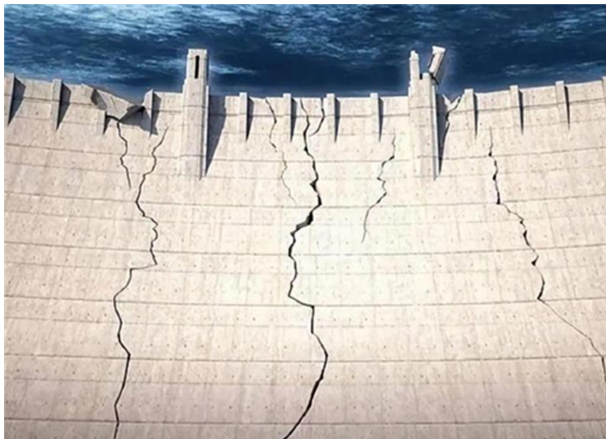
图1 水利工程混凝土裂缝
