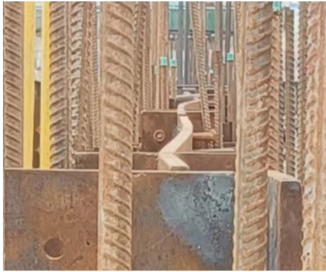
图3-1 钢板墙焊接挠曲变形缺陷图
