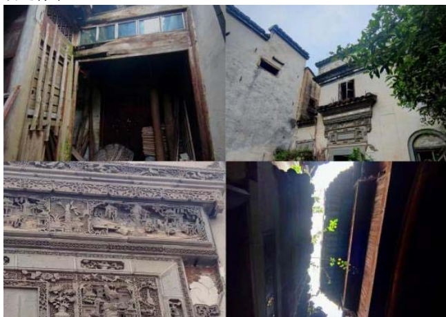
图3 查济徽派建筑破损图(自摄)
